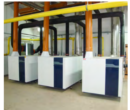
Kotlovnica Športni center
